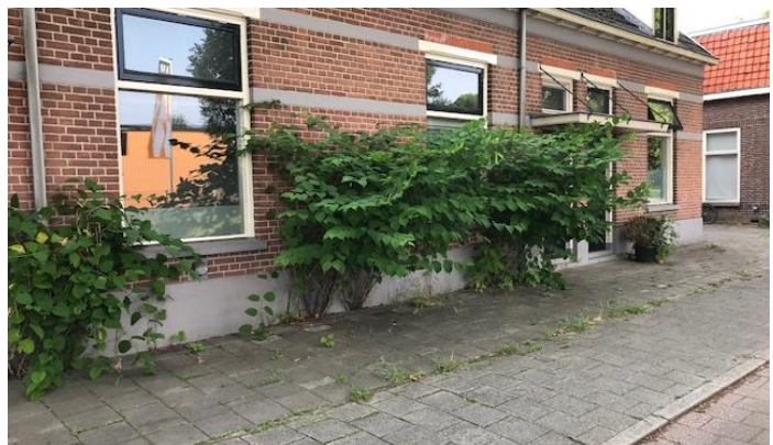
Door het ontbreken van kennis bij bewoners wordt de JDK bij deze woningen als gevelbeplanting onderhouden. Wortels groeien direct tegen de fundering en in het trottoir. (Deventer, 2018)
