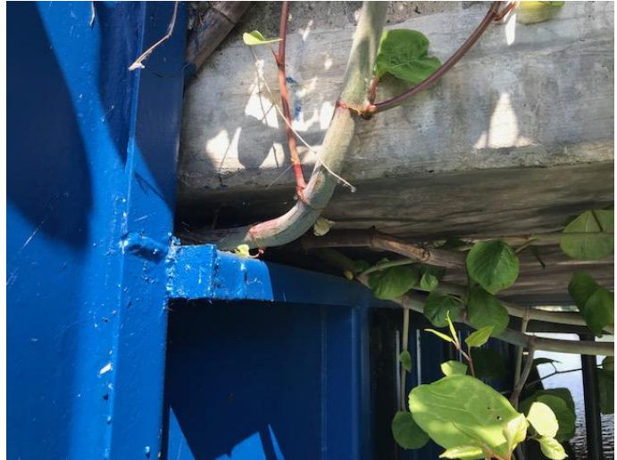
Forse JDK-stengels groeien in de constructie en het landhoofd van een brug (Amersfoort 2017)
